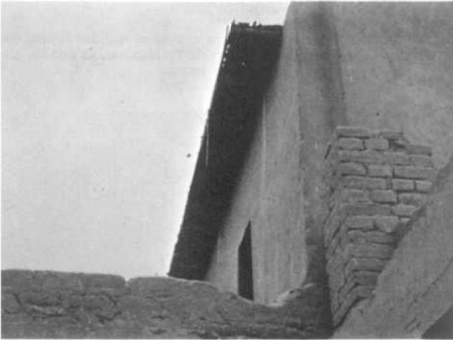
FIGURA 6.—Voladizo de un entramado formado por cañas y paja, soportado por vigas originales, que se cubría con el mismo material utilizado en la pasta de unión de los adobes.
