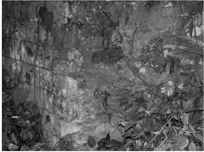
Figura 6: Detalle del muro oeste de la Estructura 32 (obsérvese cómo el núcleo de mortero y piedras irregulares sigue en pie allí donde han caído los sillares que lo revestían).
