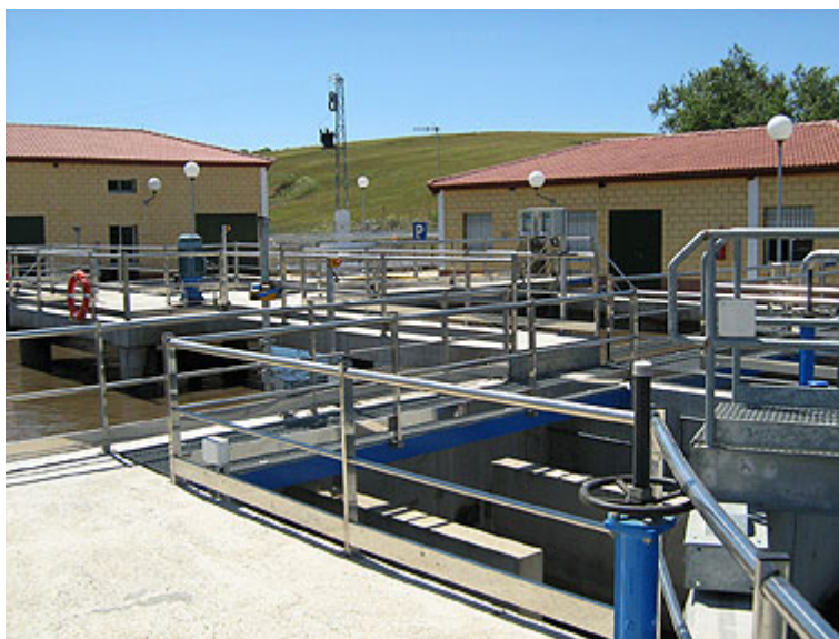
Foto nº 14. EDAR de Bonares. Antigua mancomunidad de Aguas del Condado.
