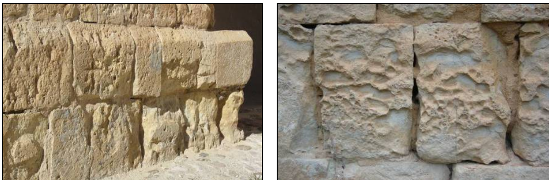
Figuras 2 y 3. Iglesia de San Miguel Arcángel en Sotosalbos. Pórtico de mampostería de caliza fuertemente deteriorado por diversos procesos naturales y antrópicos. Se aprecia el apiconado en el acabado. Meteorización y alveolización de la fachada de la ermita Virgen de la Vega (Requijada).
