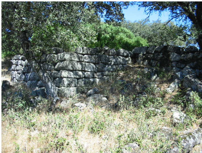
Fig. 4. Lienzo norte y torre de la fortificación del poblado minero y metalúrgico de Salas de Galiarda (@ Luis Arboledas).
