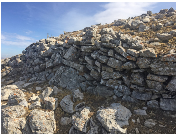
Figura 8. Detalle constructivo en el cierre NO, con hiladas apoyadas y adaptadas al afloramiento natural.
