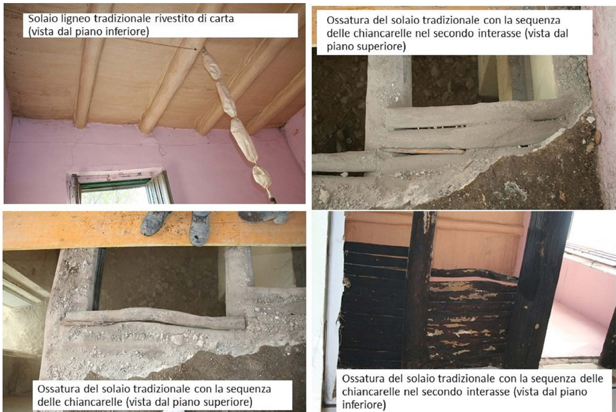
Fig. 10. Solaio tradizionale napoletano: vista dal basso con rivestimento in carta; vista dal piano superiore con le chiancarelle private del masso di conglomerato; vista delle chiancarelle dell'interasse successivo; vista delle chiancarelle con le travi dal piano inferiore (foto Pasquale Petillo 2009).
