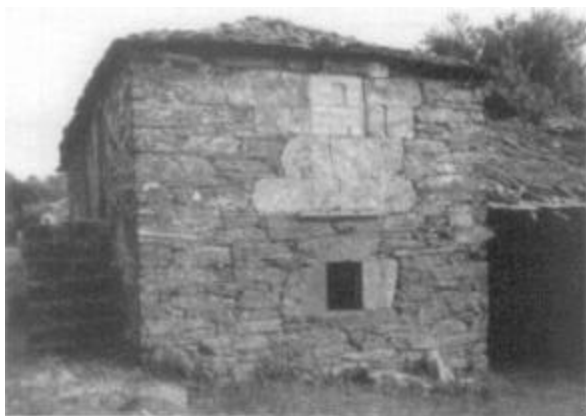
Lám. 1.- Vivienda estudiada en Vilapouca. La restauración con ladrillo obedece a una reutilización de la estancia como pajar.
