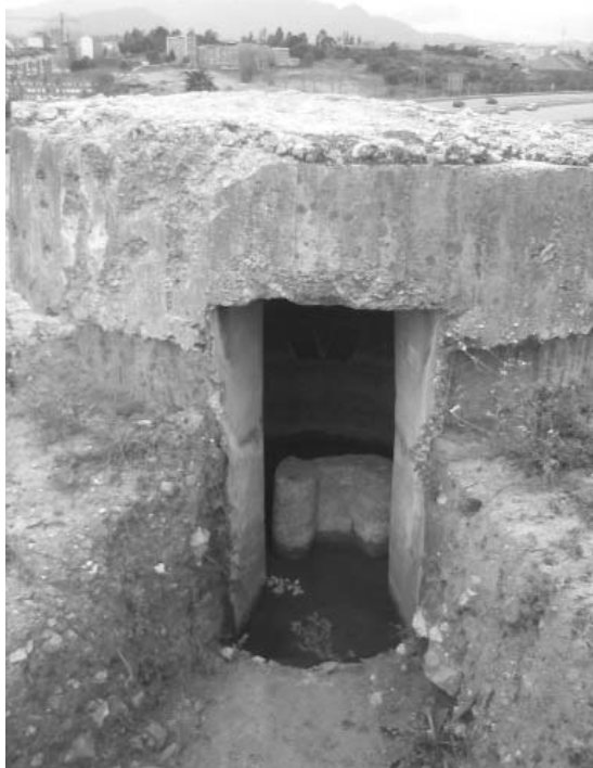
Figura 7.- El nido inundado por falta de un sistema de drenaje.
