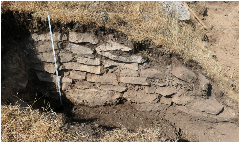
Figura 10. Paramento exterior de la muralla perimetral que rodea el castro, donde se aprecia el empleo de hiladas de lajas calcáreas y bloques de mayor tamaño en el basamento
