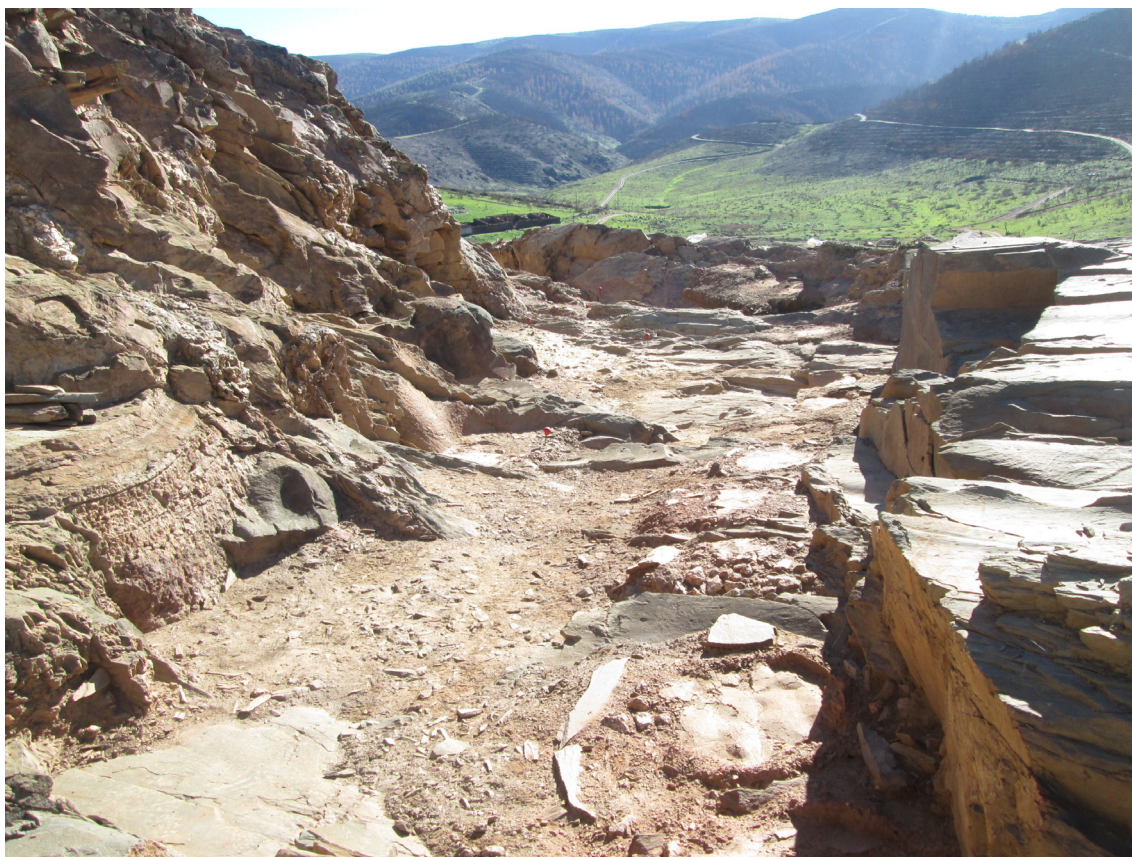
Fig. 5. Vista general del Foso 1 durante los trabajos de excavación de las baterías de Hornos (Fotografía: José Carlos Sastre Blanco).
