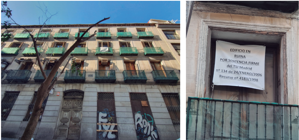
Figura 4. Estado de la fachada de dicho edificio, y detalle de una de las ventanas. Fuente: F.J. Rufián 03/04/21.
