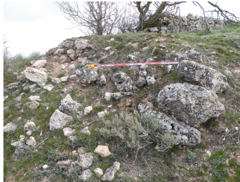
Figura 9. Aspecto actual de la muralla seccionada.
