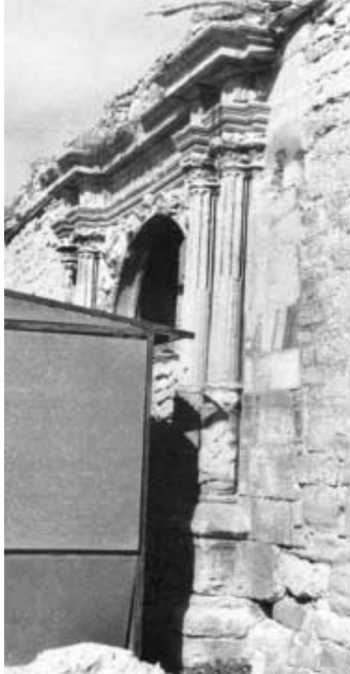
Foto 4. Fachada Oeste. Vano de acceso principal a la Casa Solariega Las Torres.
