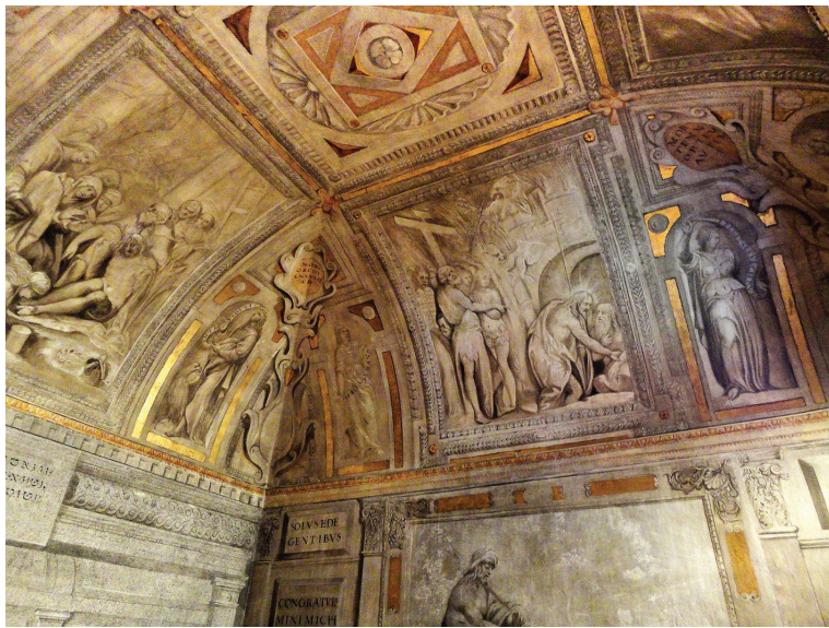
Fig. 1. Monasterio de las Descalzas Reales, Madrid. Capilla del Cristo: vista interior, ángulo noroeste.
