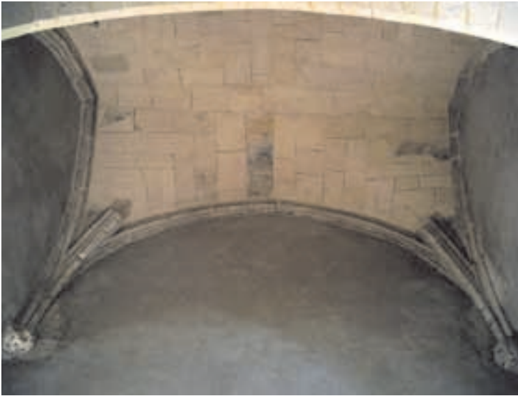
Fig. 2. Bóveda de crucería en pie, sin los nervios cruceros, perdidos en un bombardeo de la Segunda Guerra Mundial, en la iglesia de santo Domingo en Cagliari, Cerdeña.
