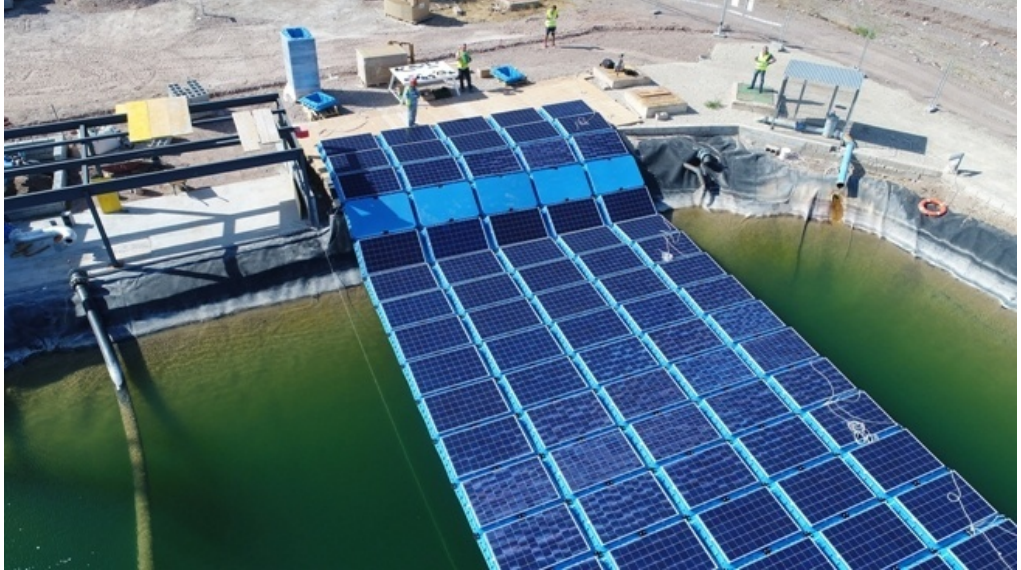
Figura 2. Proceso de instalación fotovoltaica flotante de Isifloating para la Comunidad de Regantes de Mérida (Badajoz)
