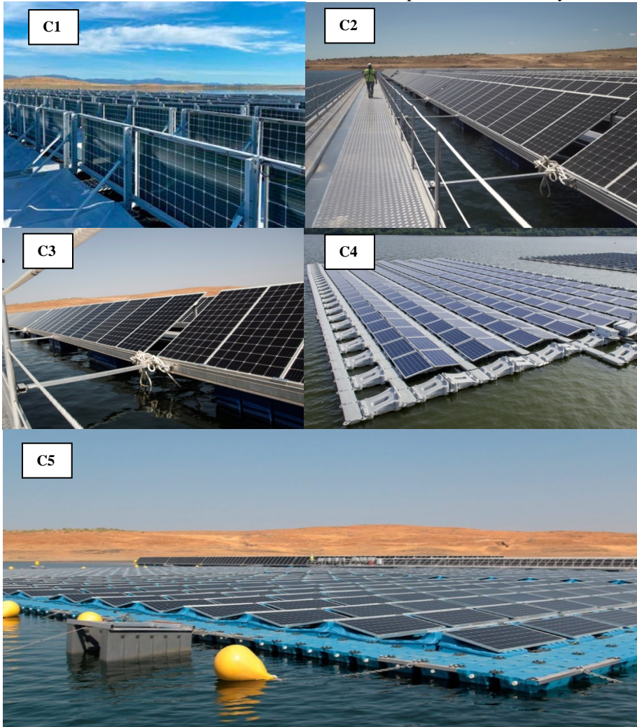
Figura 8. Planta fotovoltaica flotante de Sierra Brava. Campos C1, C2, C3, C4 y C5
