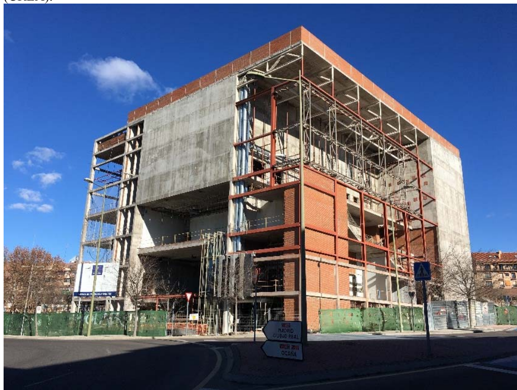
Figura 6. Construcción paralizada del Centro Regional de Expresión Artística Quixote (CREA).
