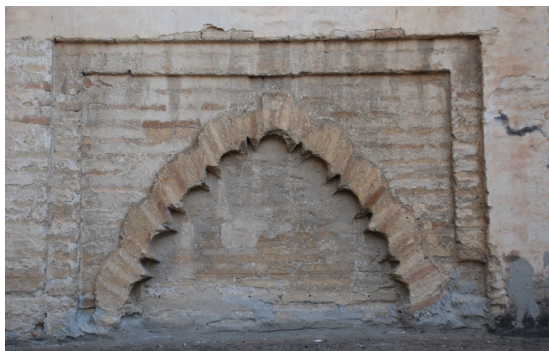
Figura 20. Arco cegado en el muro de la Epístola de la parroquia de San Juan.
