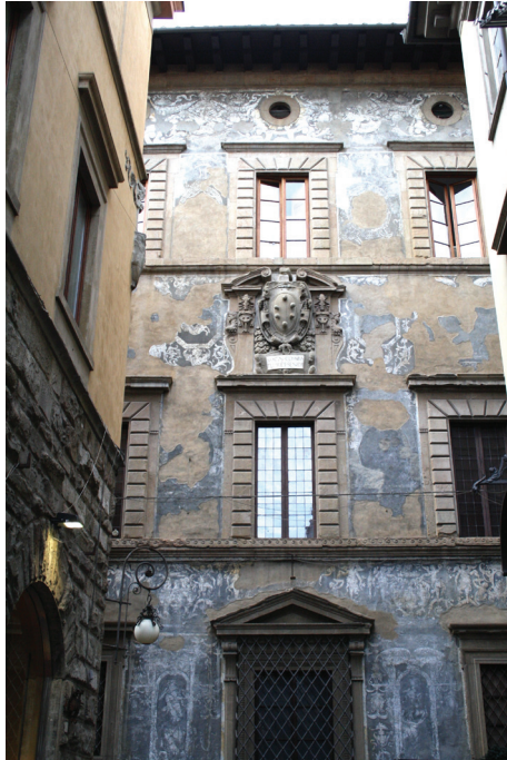
Fig. 2. Bartolommeo Ammannati y Giorgio Vasari, Fachada del Palacio Ramirez de Montalvo , Borgo degli Albizi (Florencia), segunda mitad del siglo XVI.
